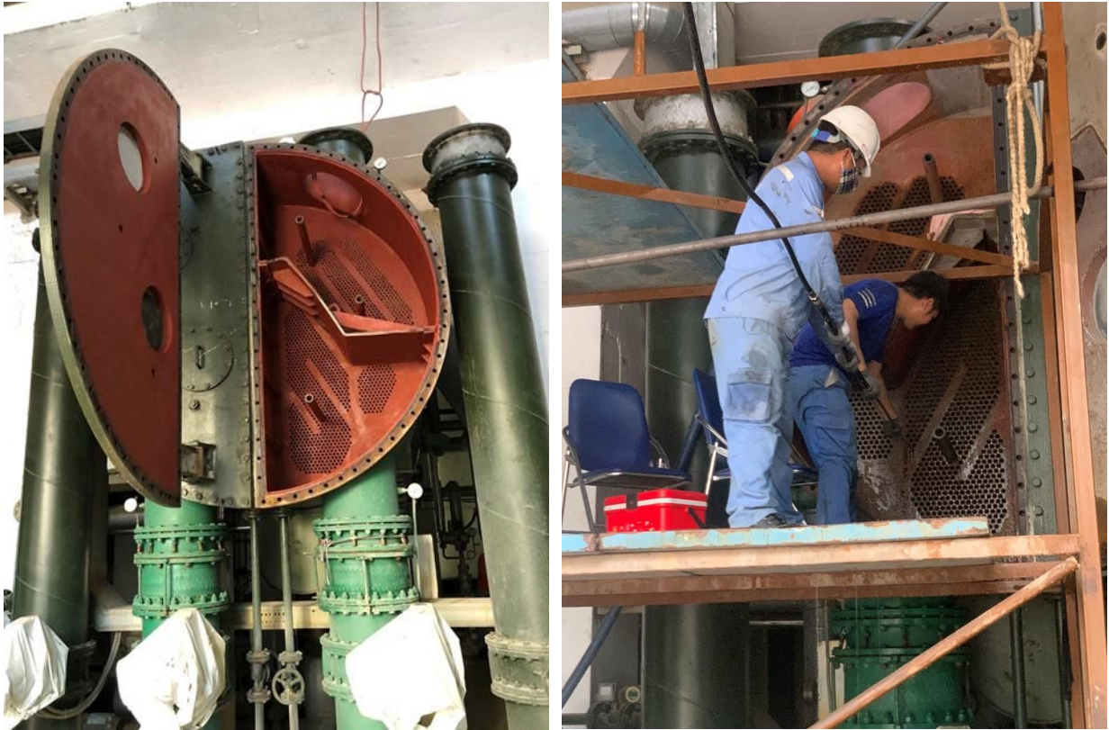
Hình 4.16. Bình ngưng hệ thống thu hồi nhiệt
