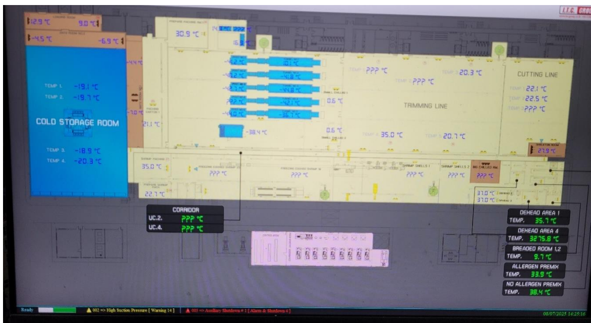
Hình 1.11. Hệ thống điều khiển trung tâm cho hệ thống cấp đông của nhà máy
