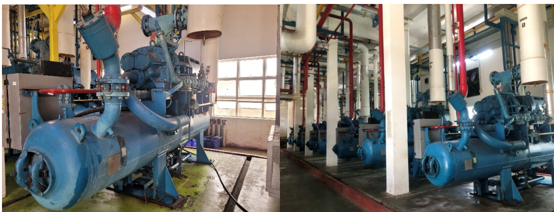
Hình 4.6 Máy nén lạnh trực vít tại nhà máy
