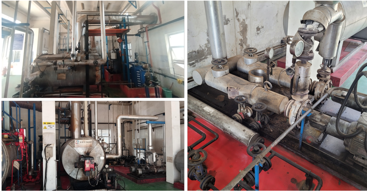
Hình 1.12. Lò dầu tải nhiệt và hệ thống bơm dầu
