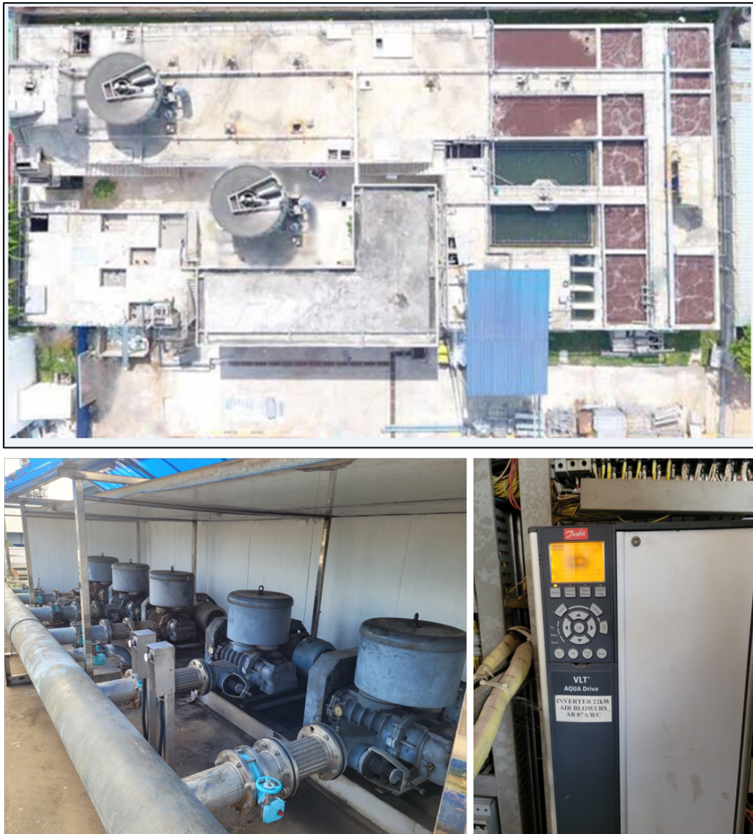
Hình 1.16. Hệ thống xử lý nước thải
