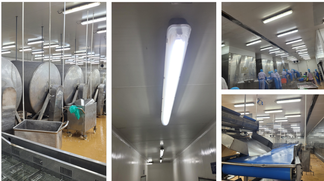
Hình 1.7. Hệ thống chiếu sáng tại nhà máy
