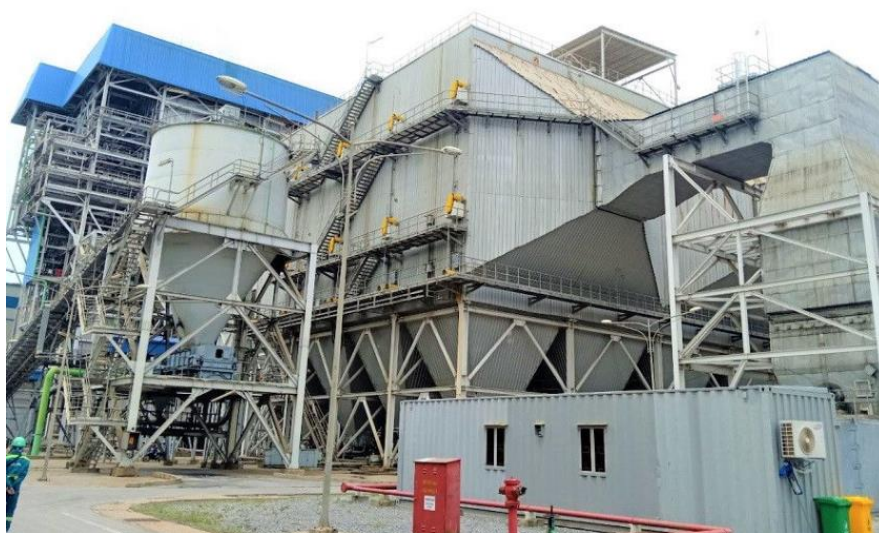
Hình 1.13. Hệ thống lọc bụi tĩnh điện của Công ty
