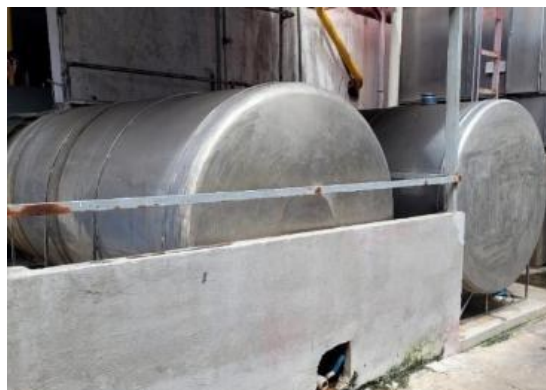
Hình 4.3 Bồn chứa nước nóng cho vệ sinh nhà xưởng
