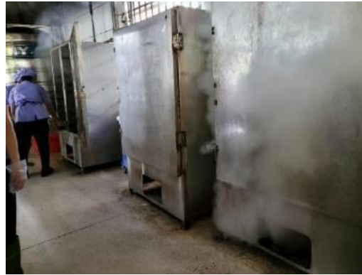
Hình 4.2 Các tủ nấu cơm sử dụng hơi
