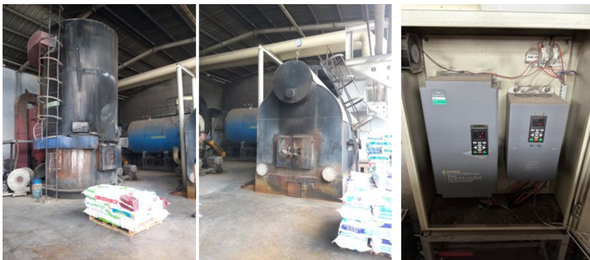
Hình 1.3. Hiện trạng nhà lò hơi
