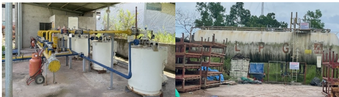
Hình IV.13. Hệ thống cung cấp LPG của Công ty
